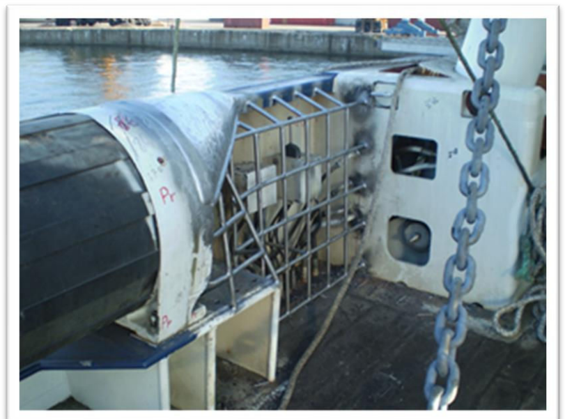
Protección para tubos hidráulicos.
